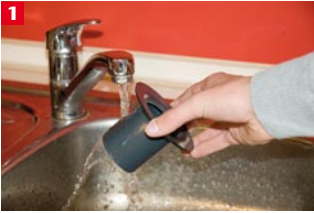
Den Geruchsverschluss unter Wasser säubern
